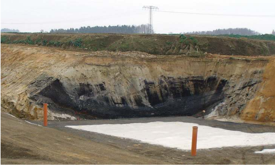
Abb. 1 Kohleführende Tertiärscholle (schwarz) in mittelpleistozäne Sedimente (graubraun und graugrün) eingeschlossen; Südböschung der Brückenbaugrube für die Überführung der Landstraße S 128 über die B 178n zwischen Niederoderwitz und Großhennersdorf; im Vordergrund das Betonfundament der Brücke, am linken Bildrand der Beginn der rechten Straßenböschung der B 178n in Richtung Zittau; über der Böschung ca. 2 m hohe Abraumkippe aus Lößlehm und Mutterboden; Böschungshöhe ca. 5 m, Bildbreite ca. 40 m. Foto Andreas Scholz, 20.11.2011.
